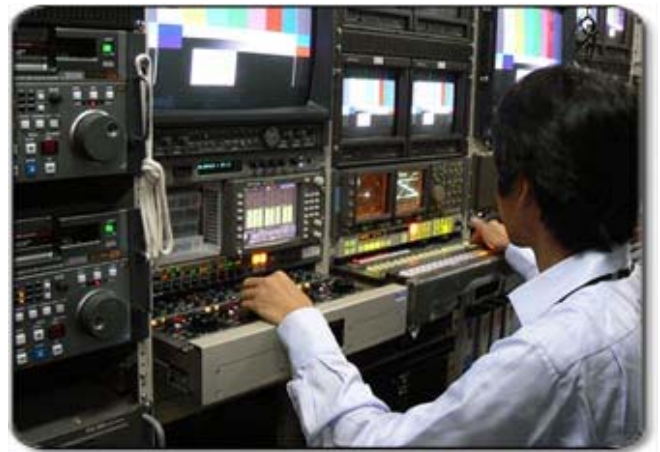
中継車内に設置された WFM700M 他監視機器
