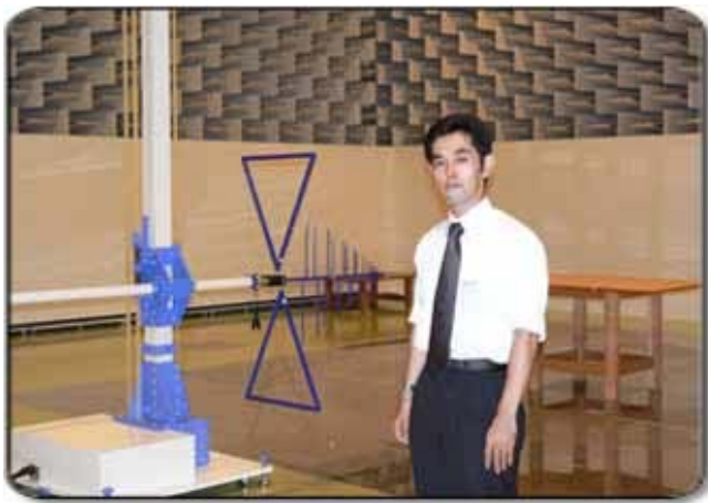
EMC 測定用に大型ターンテーブルを備えた 10m 法電波暗室
